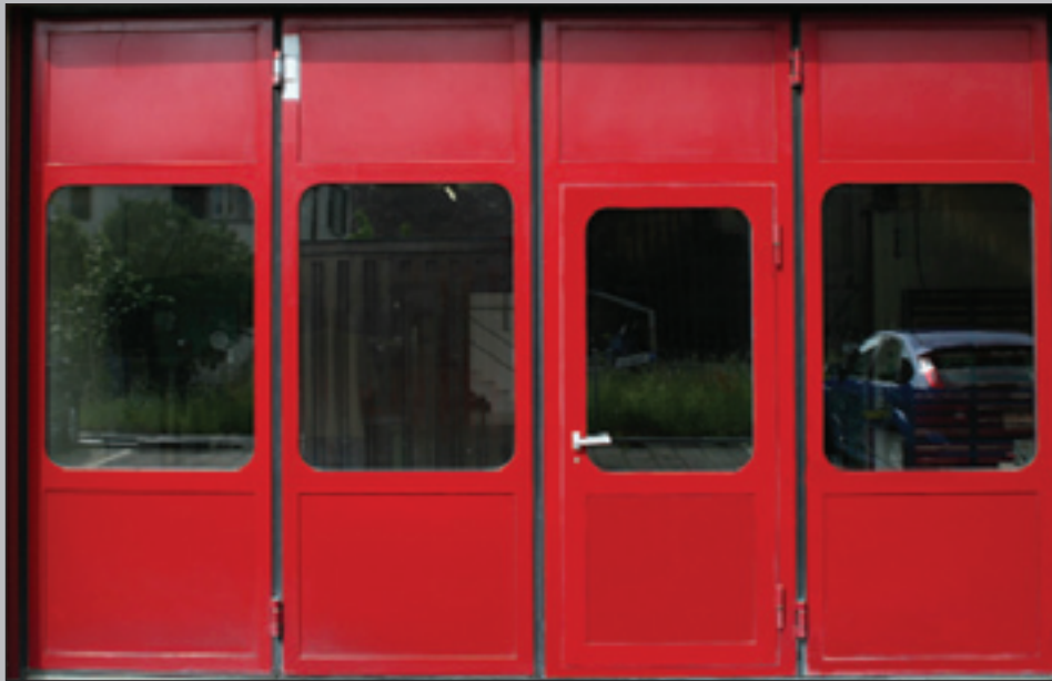
Faltschiebetor und Brandschutztor
